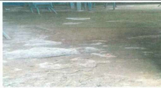
Foto 4: Se observa el deterioro en el piso de torta de cemento, y se sustituirá con piso cerámico
